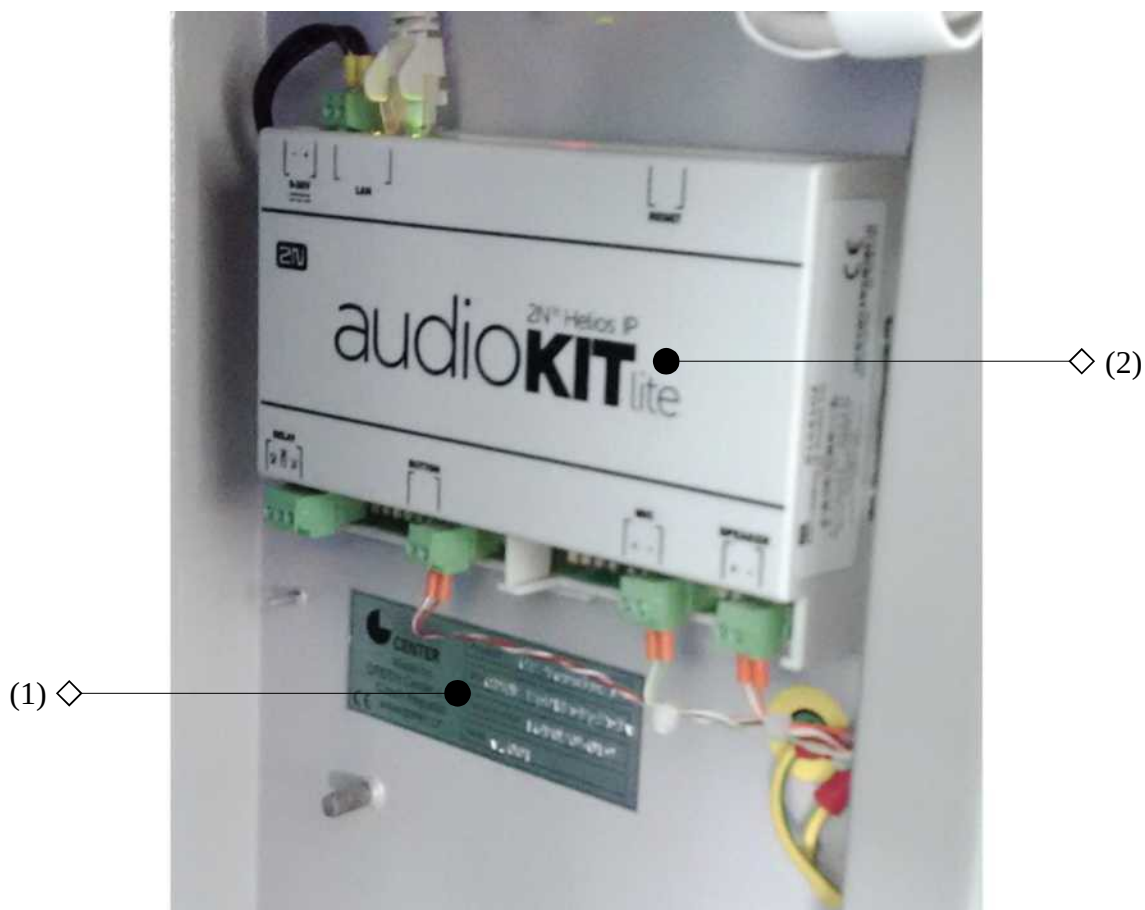
Obrázek 7: Interiér zadní stěny skříně
