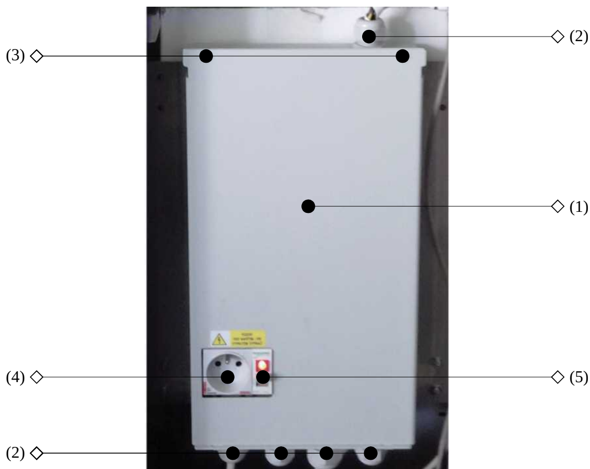
Obrázek 10: Interiér skříně terminálu parkovacího systému GP4T
