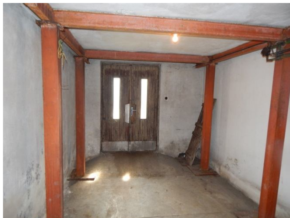
ocelový rám ve sklepení
