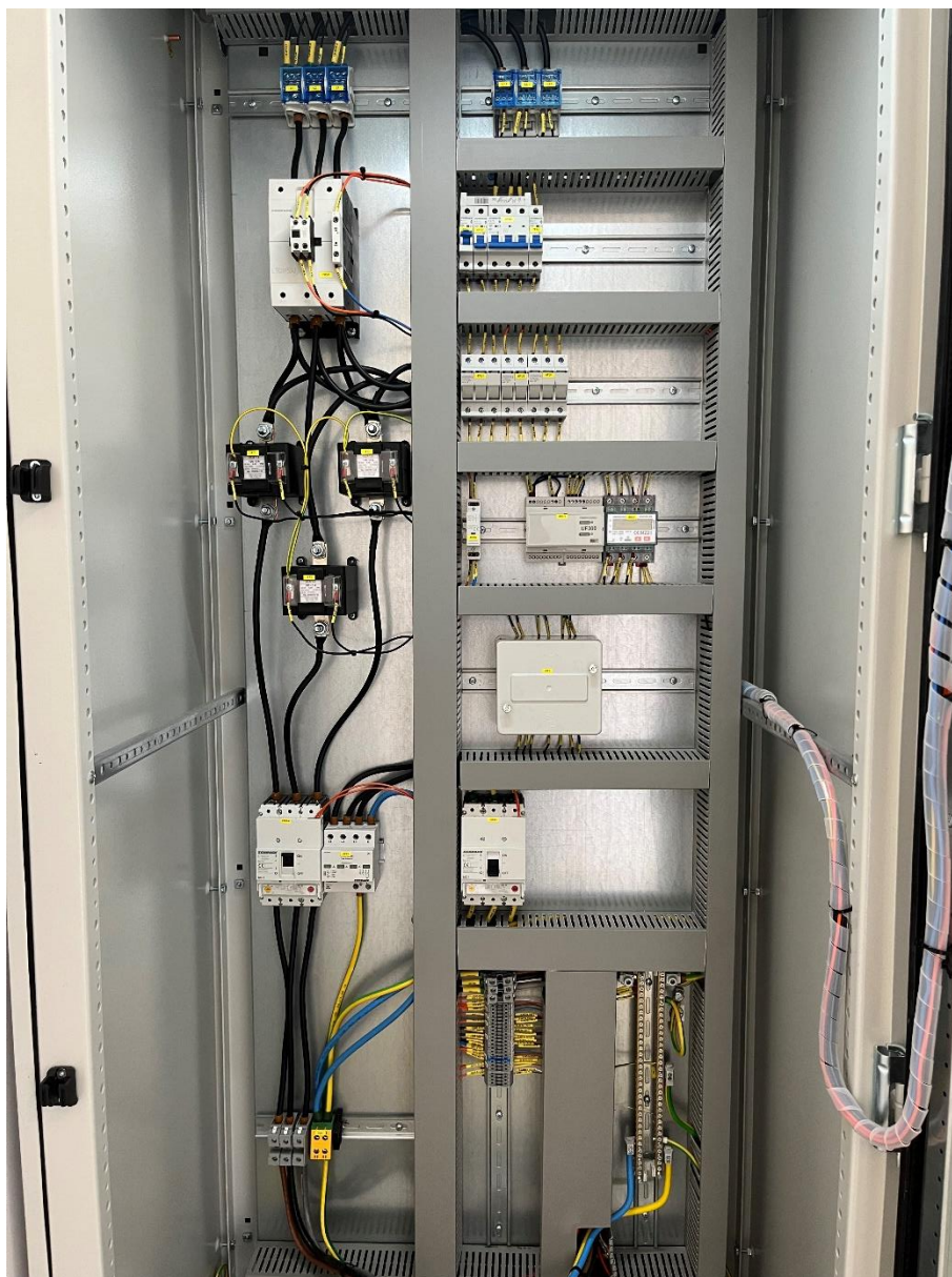
Obrázek č. 9 – Rozvaděč RFVE – AC1b
