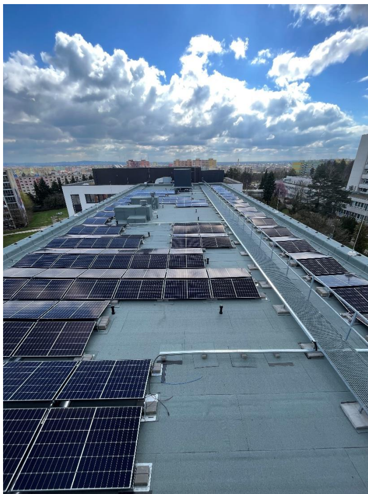
Obrázek č. 1 – FV panely HUASUN HS-B120 DS400-B umístěné na střeše budovy P
