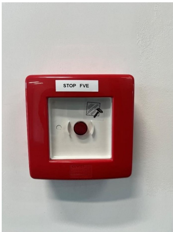
Obrázek č. 7 – STOP FVE s kladívkem pro rozbití skla
