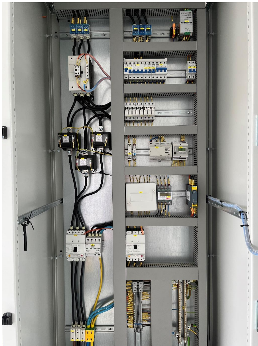
Obrázek č. 5 – Rozvaděč RFVE – AC2
