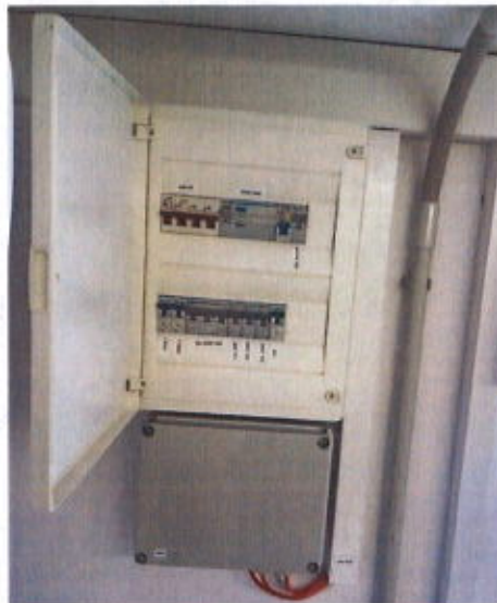
Obrázek č. 11 – rozvaděč elektroinstalace technologického kontejneru
