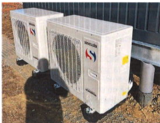
Obrázek č. 13 – venkovní jednotka klimatizace
