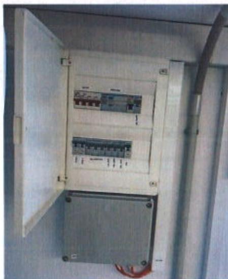
Obrázek č.7 – rozvaděč elektroinstalace technologického kontejneru (RZ)
