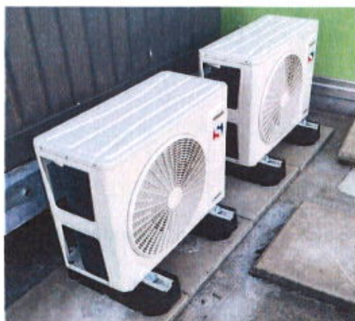
Obrázek č.9 – venkovní jednotka klimatizace
