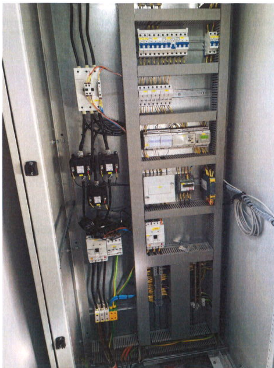
Obrázek č.5 – Rozvaděč RFVE-AC2
