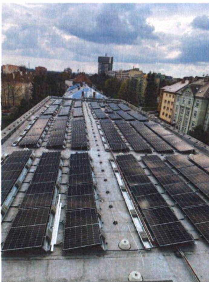
Obrázek č. 1 – FV panely HUASUN HS-B120 DS400-B umístěné na střeše budovy S
