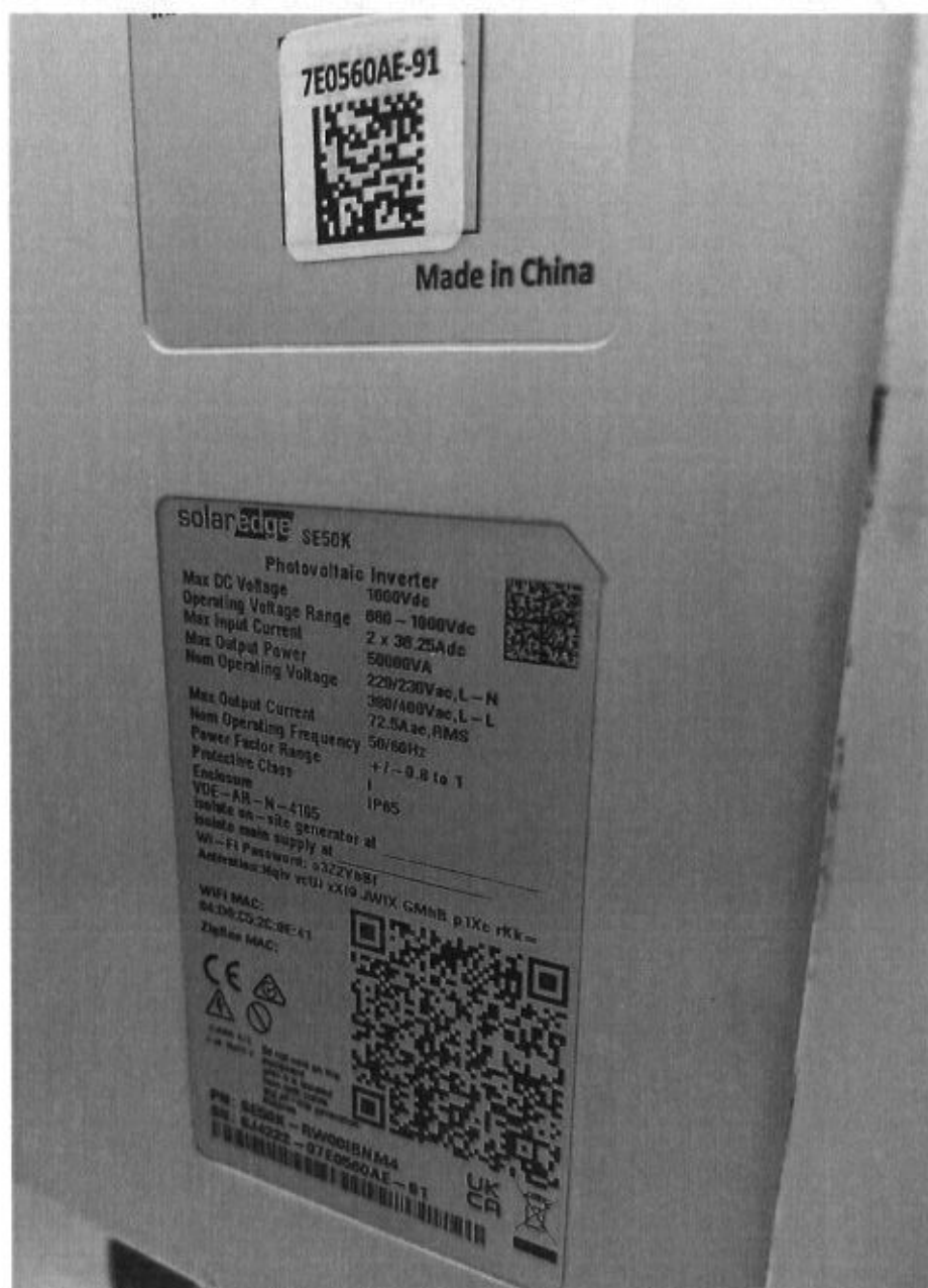
Obr.1: Štítek střídače FVE SE50K na budově P
