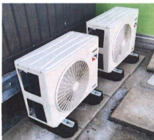
Obrázek č.9 – venkovní jednotka klimatizace
