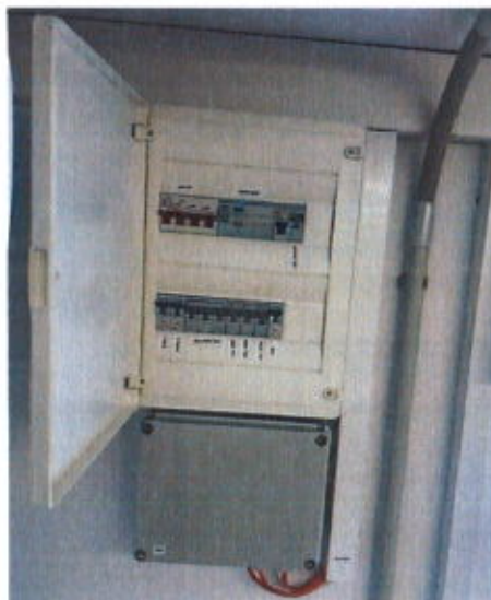
Obrázek č. 7 – rozvaděč elektroinstalace technologického kontejneru (RZ)
