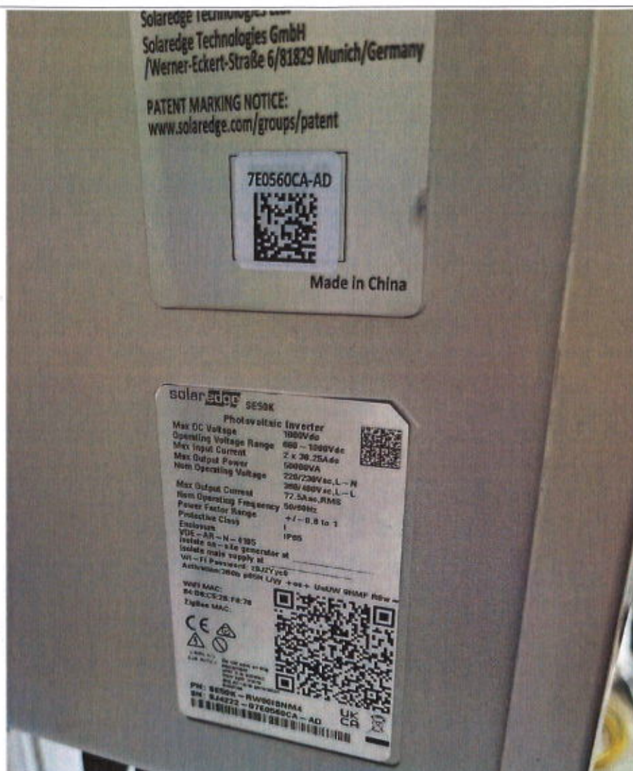
Obr. 2: Štítek střídače FVE SE50K na budově S
