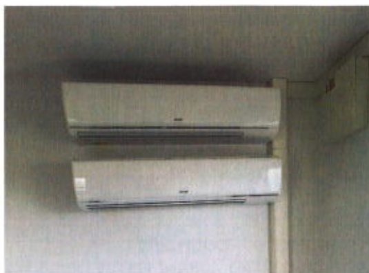
Obrázek č.8 – vnitřní jednotka klimatizace
