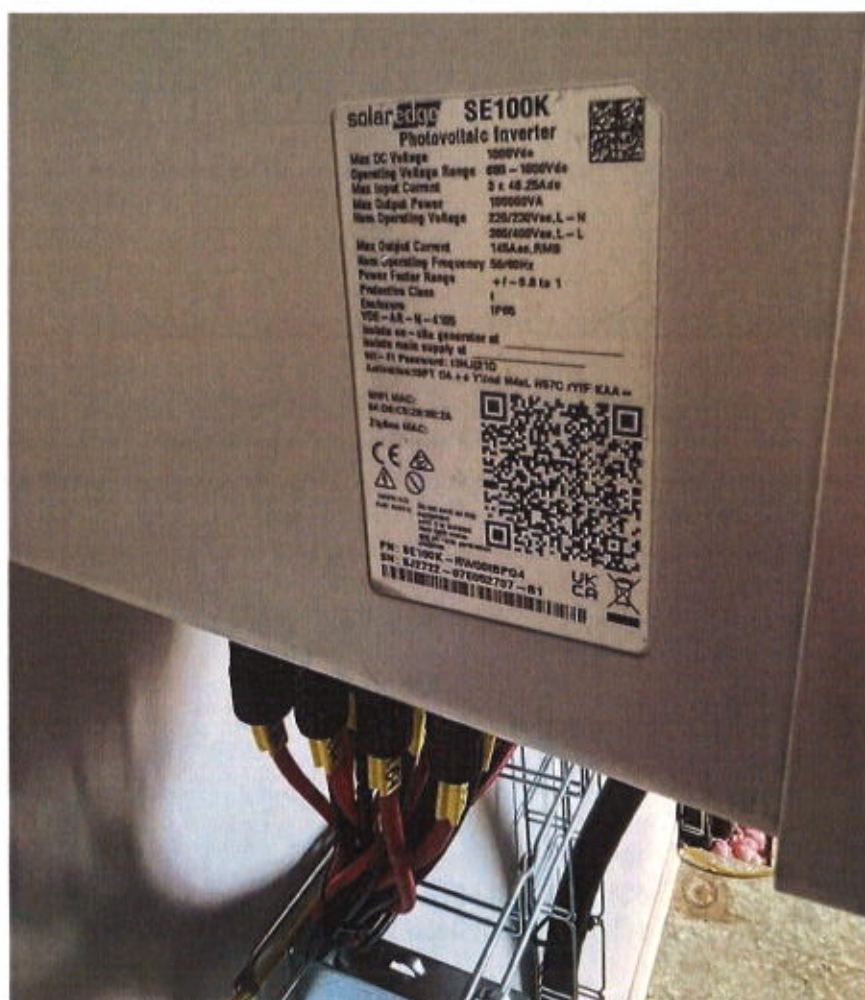
Obr.1: Štítek střídače FVE SE100K na budově A
