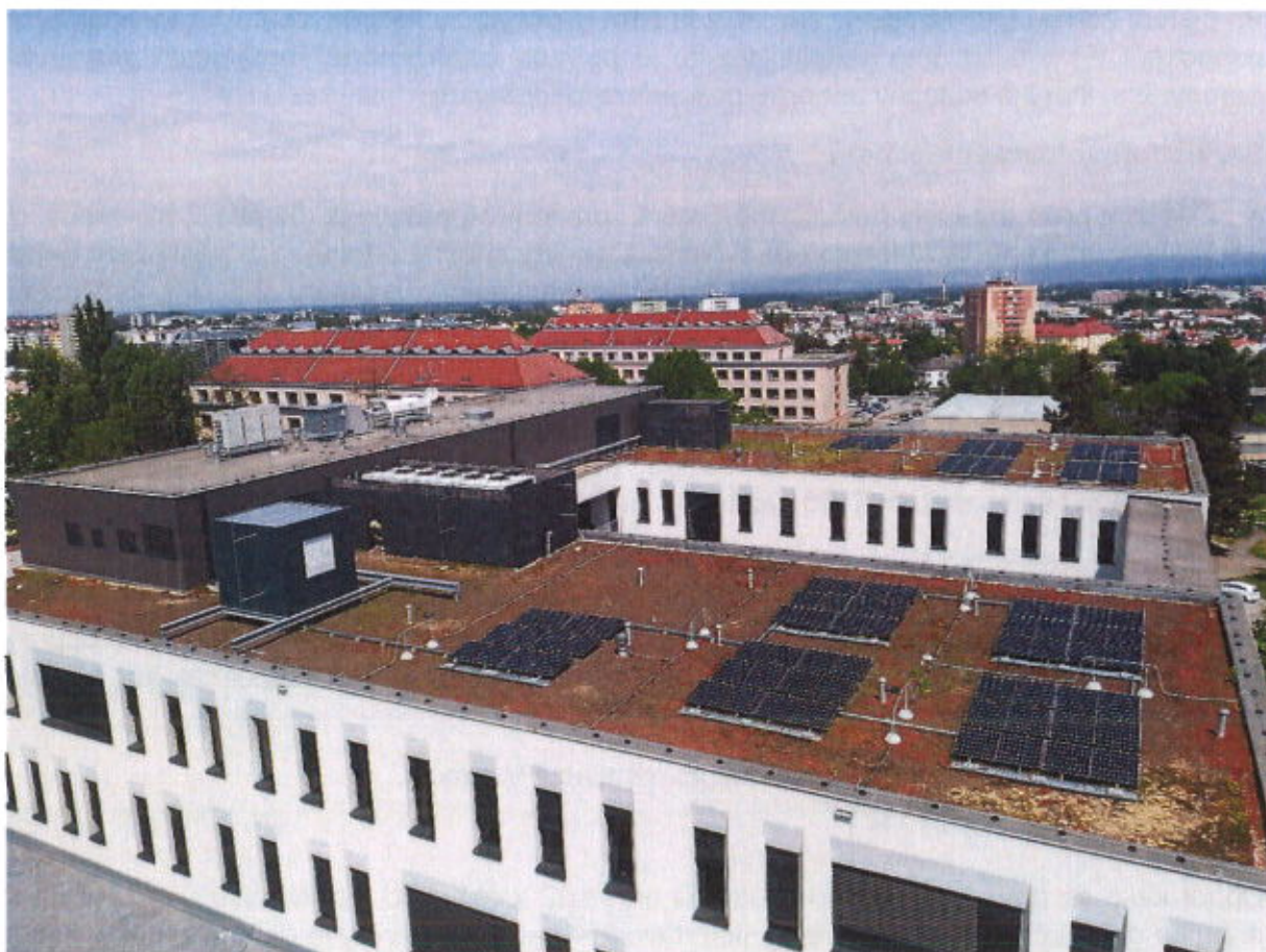
Obrázek č. 1 – FV panely HUASUN HS-B120 DS400-B umístěné na střeše budovy Y
