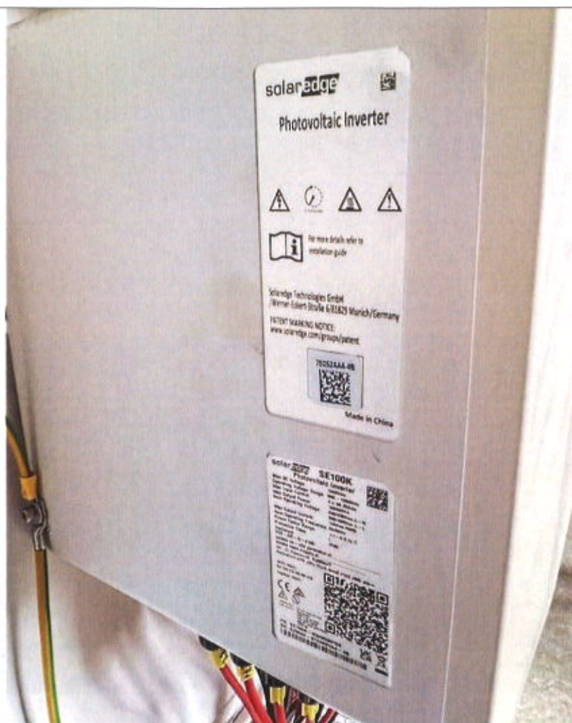
Obr.3: Štítek střídače FVE SE100K na budově A
