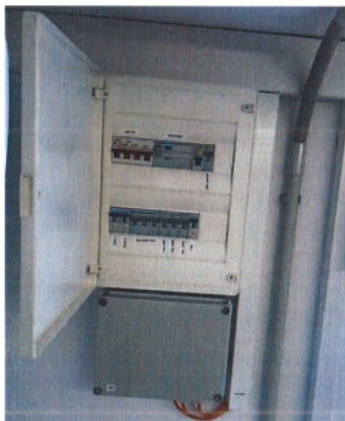
Obrázek č. 7 – rozvaděč elektroinstalace technologického kontejneru (RZ)
