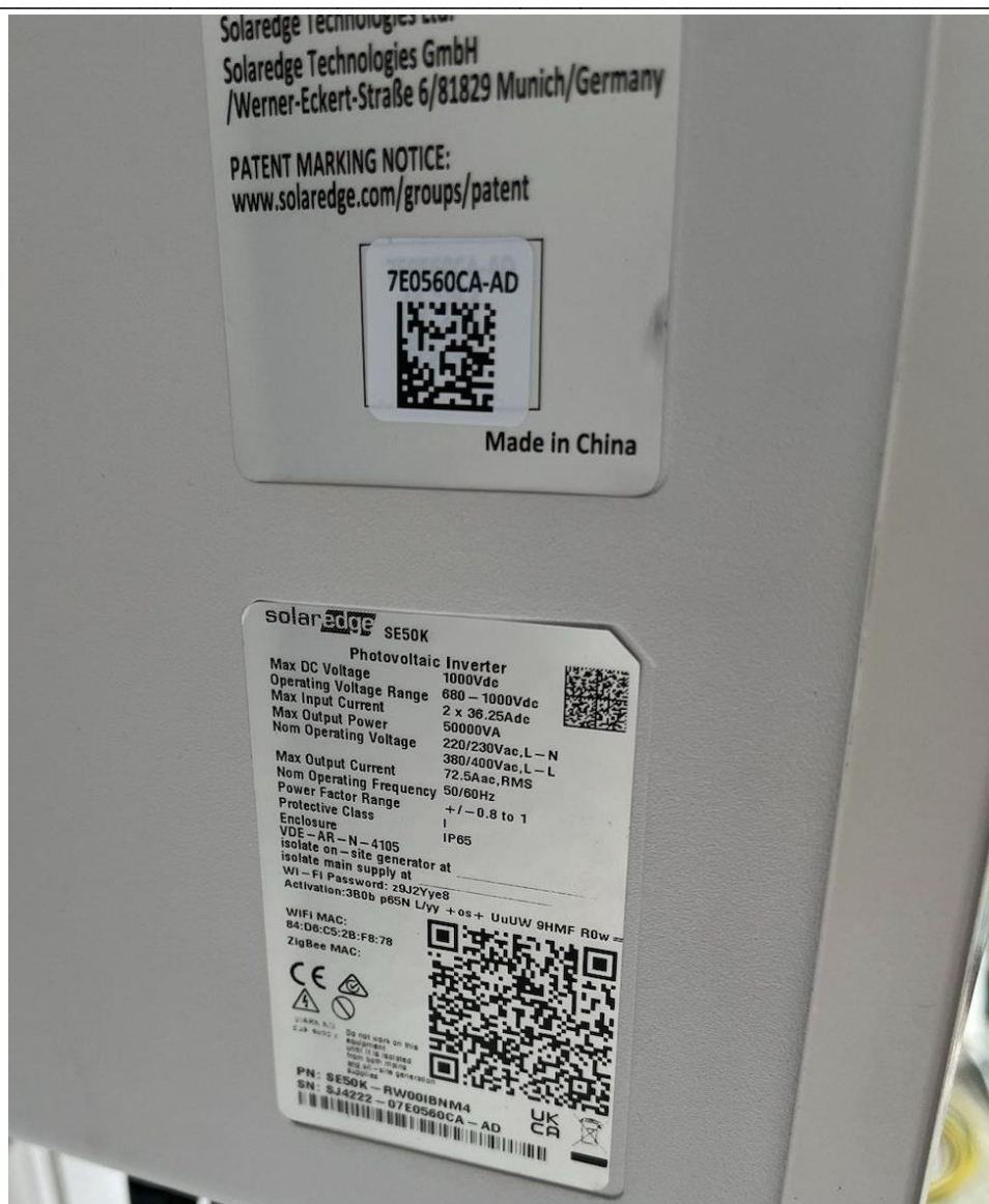
Obr. 2: Štítek střídače FVE SE50K na budově S
