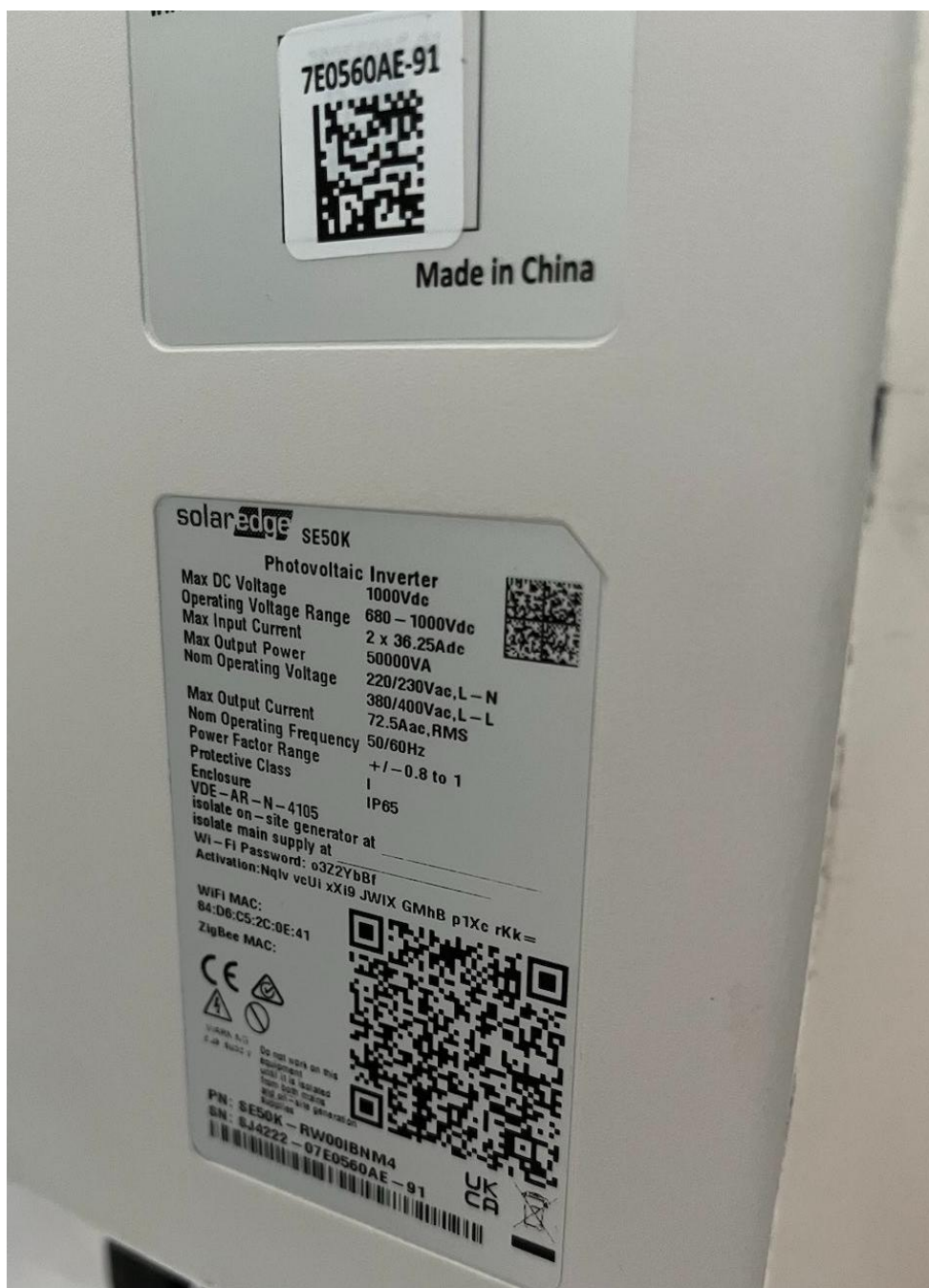
Obr.1: Štítek střídače FVE SE50K na budově P
