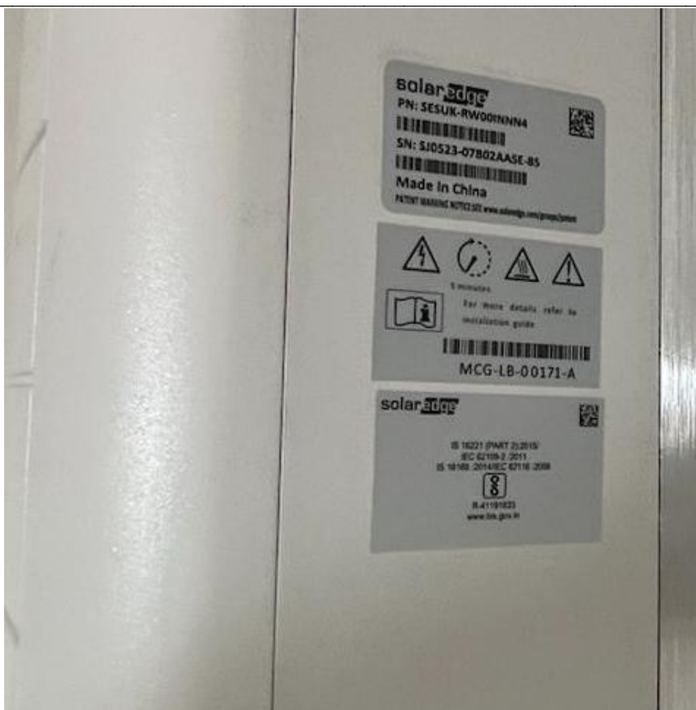
Obr.2: Štítek střídače FVE SE100K na budově A
