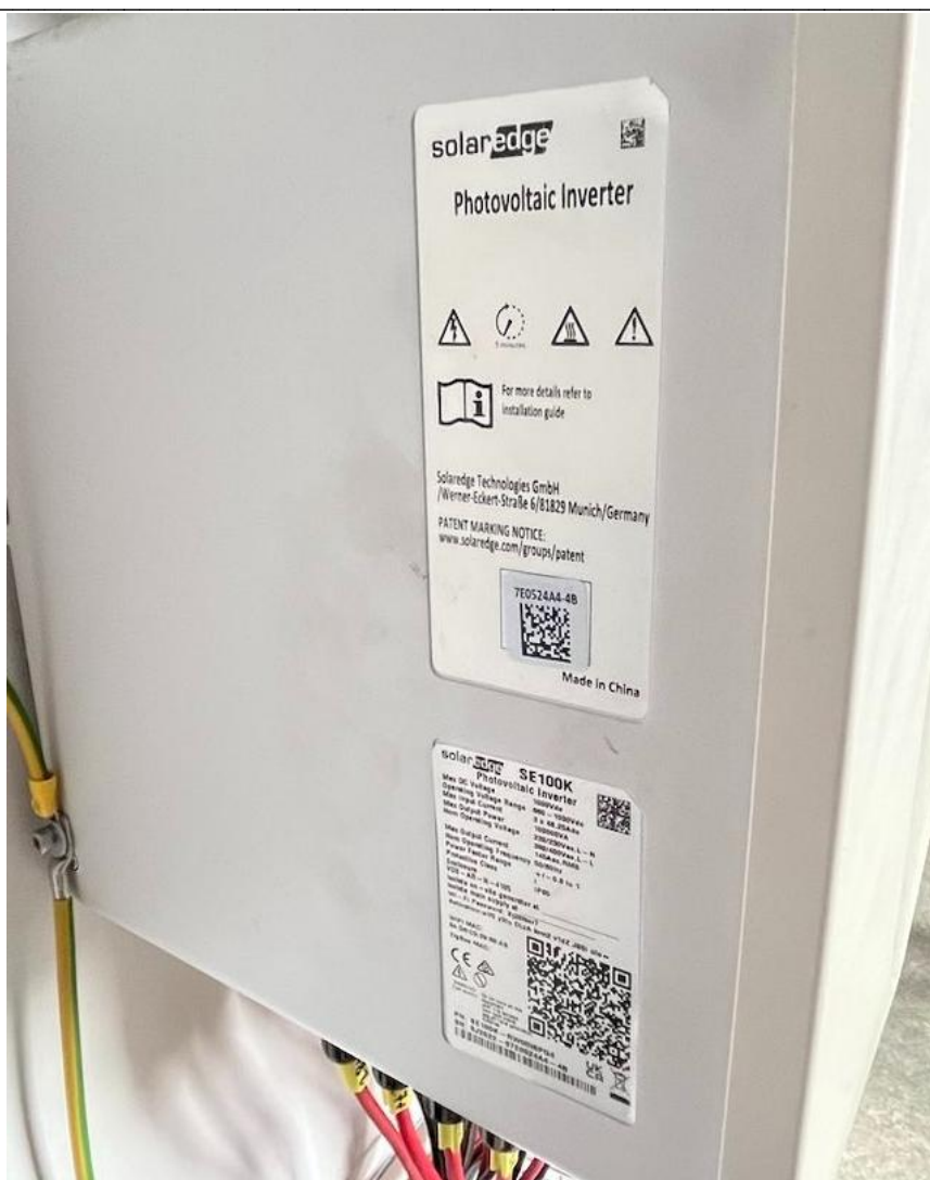
Obr.3: Štítek střídače FVE SE100K na budově A
