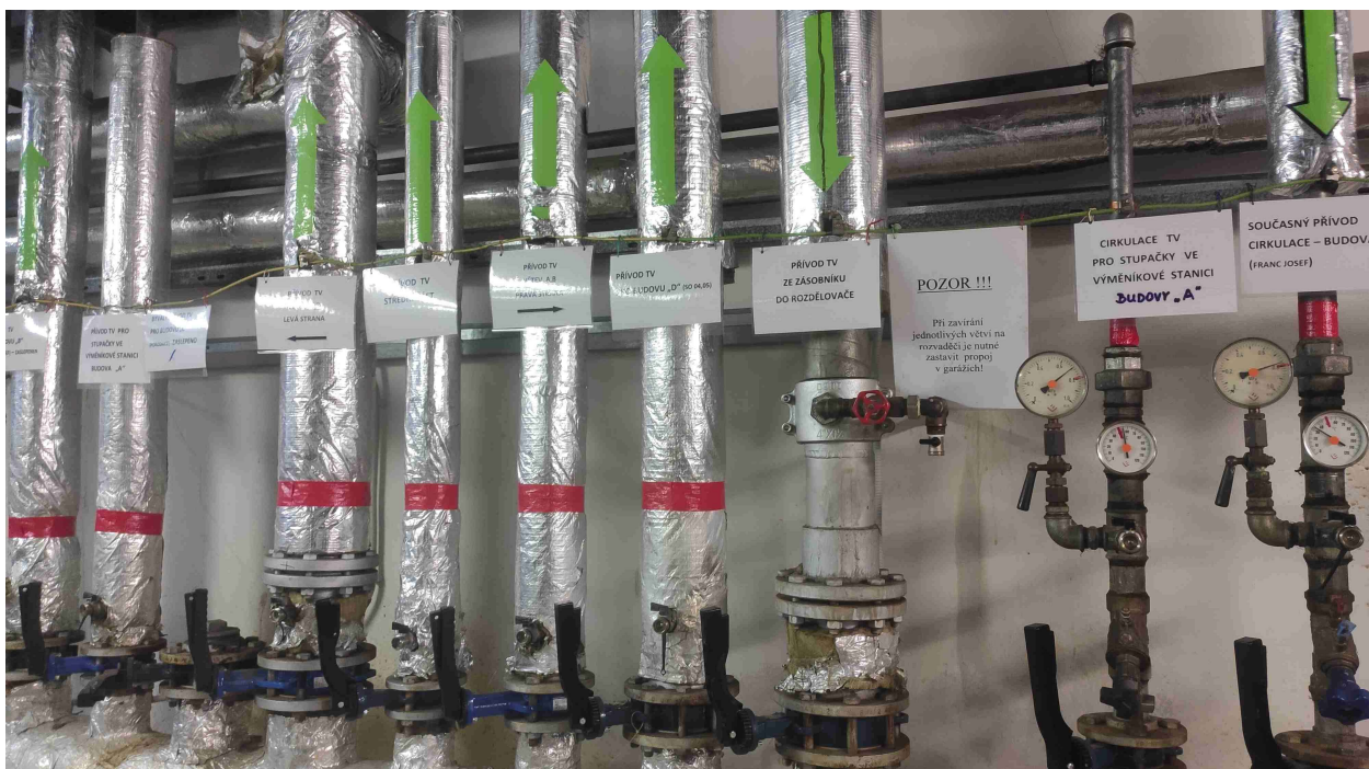
Obrázek č. 3.1.5: Fotografie výměňkové stanice objektu A
