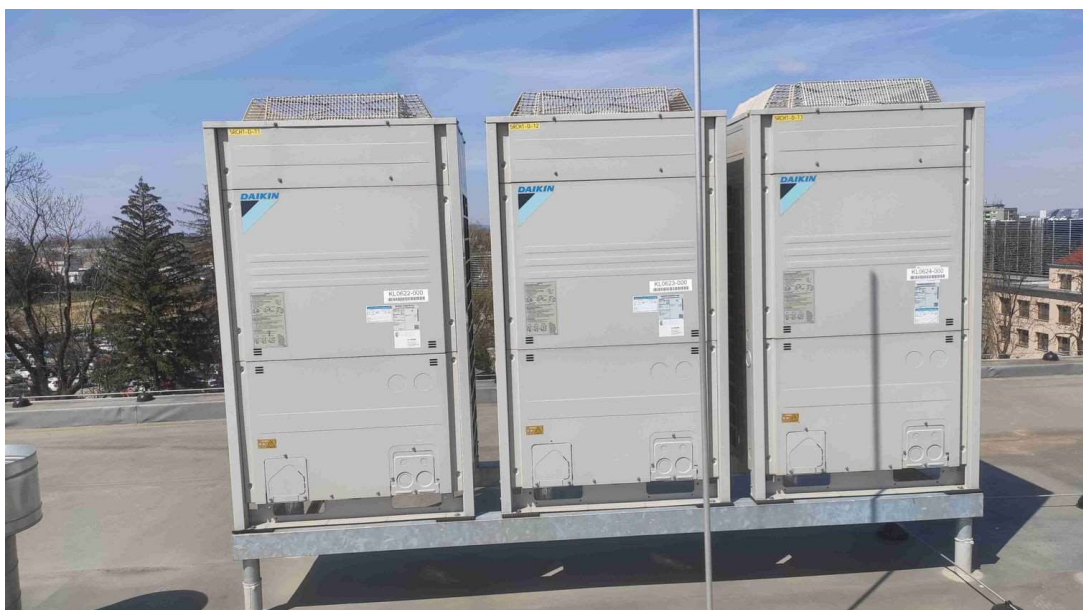
Obrázek č. 3.1.8: Fotografie chladicích jednotek na objektu Y
