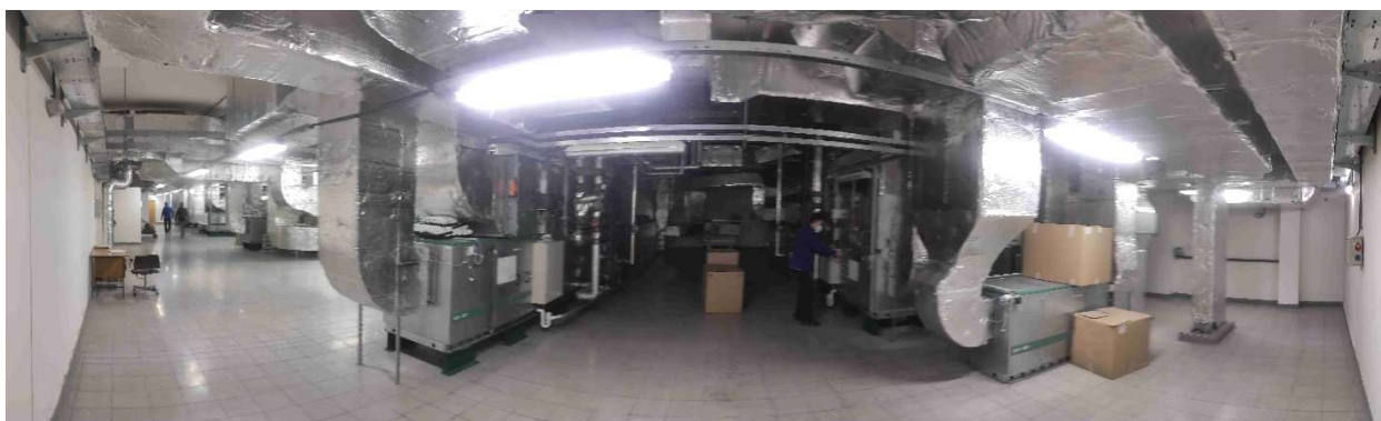
Obrázek č. 3.1.6: Fotografie VZT jednotky objektu A
