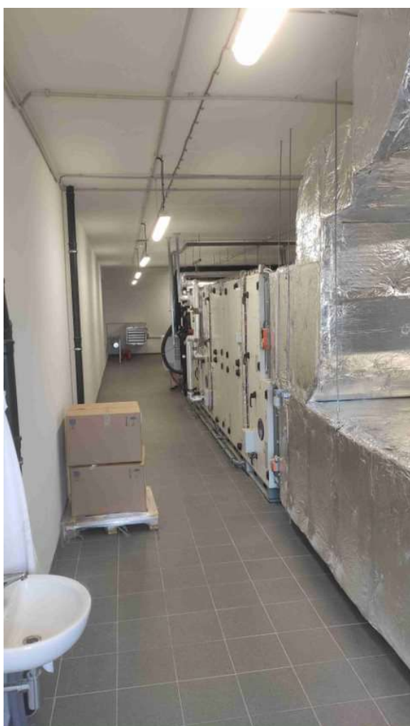
Obrázek č. 3.1.7: Fotografie VZT jednotky objektu P
