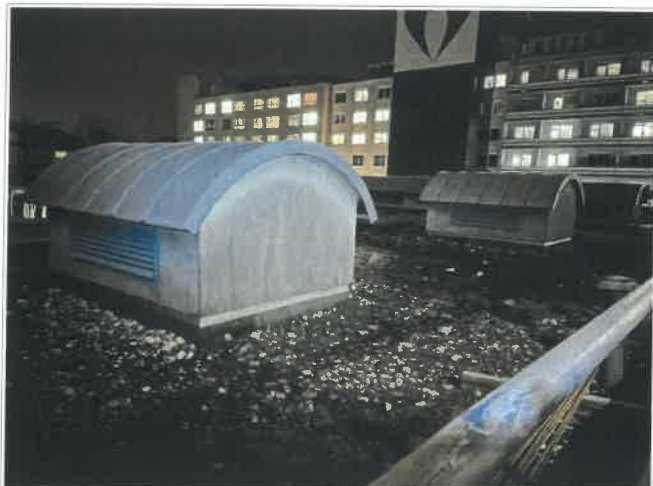
Obr./13/ Zdroje hluku na budově A
