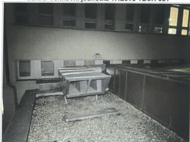
Obr.18/ Výfuk vzduchu z technické místnosti pro chlazení LU1
