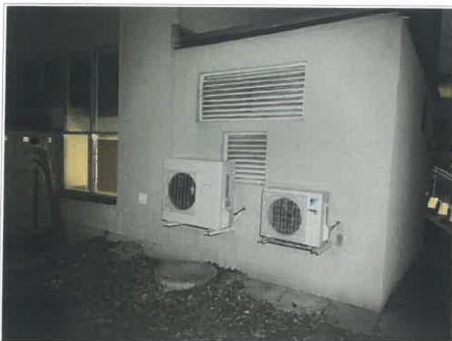
Obr./2/ Chladicí jednotky a sání vzduchu pro chlazení LU3
