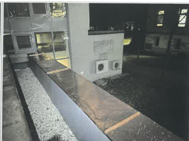
Obr./3/ Chladicí jednotky a sání vzduchu pro chlazení LU3
