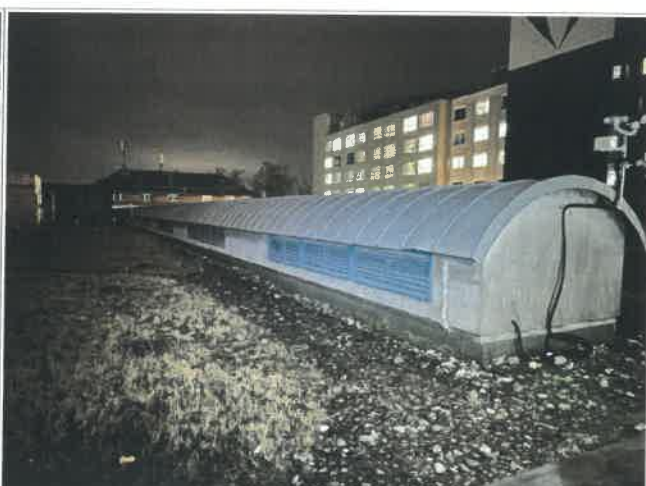
Obr./14/ Zdroje hluku na budově A
