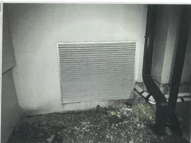
Obr./11/ Sání vzduchu do technické místnosti chlazení LU1
