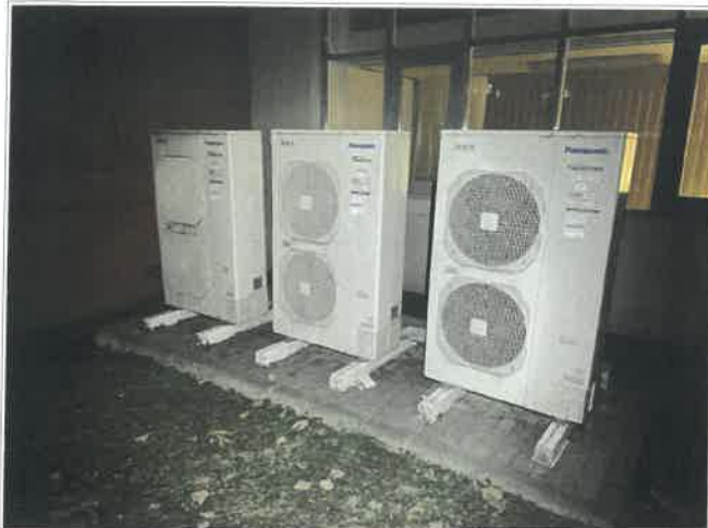
Obr./10/ Stávající chladicí jednotky Panasonic
