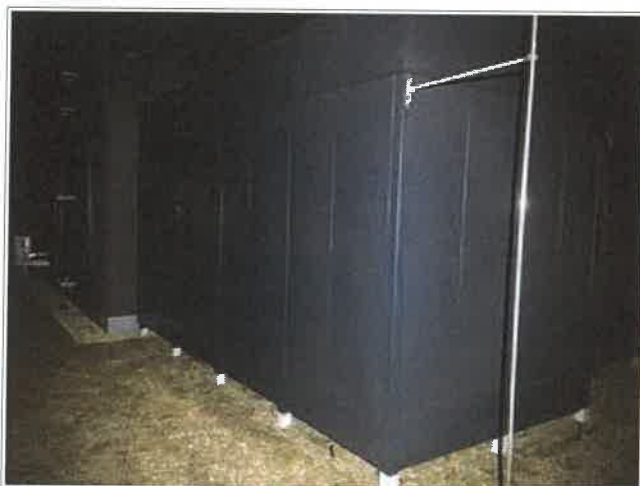
Obr. /9/ Protihluková stěna kolem chladicí jednotky CLINT multi power MHA/K
