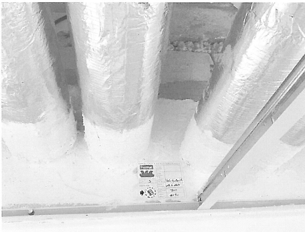
Požární ucpávka č.3 – prostup potrubí UT
