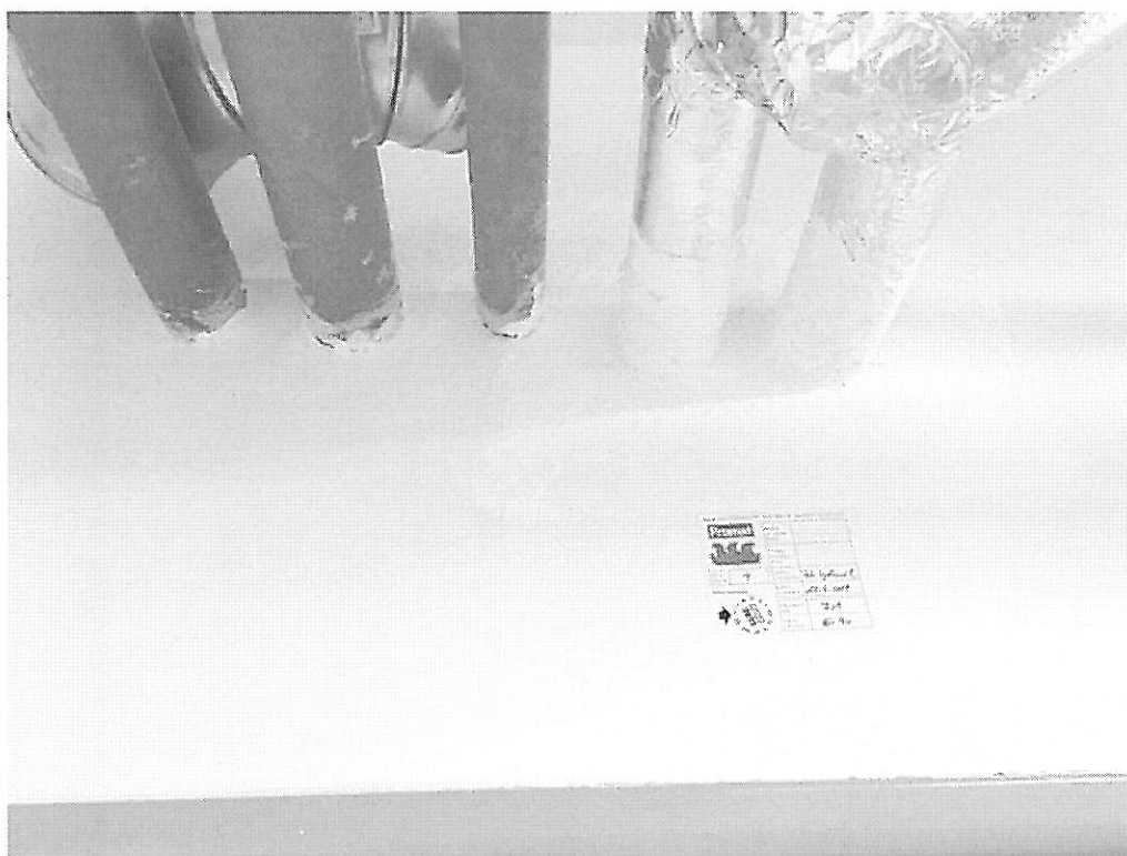
Požární ucpávka č.9 – prostup potrubí UT
