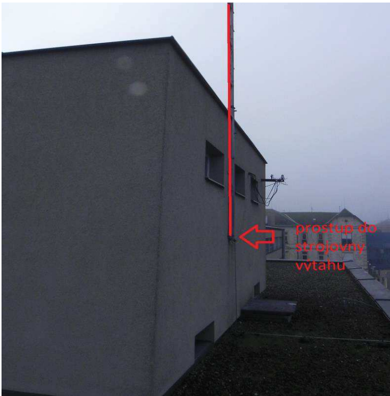
Strojovna výtahu – vstup k anténě
