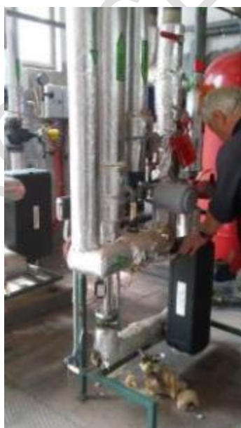
Obrázek 34–Výměňková stanice OPS YA
