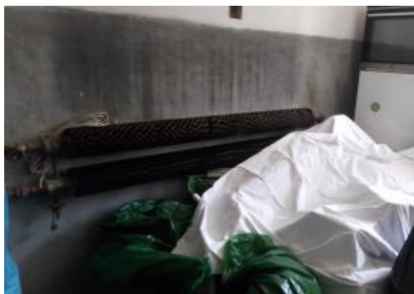
Obrázek 31 – Otopný registr s lamelami, sušárna 1.PP
