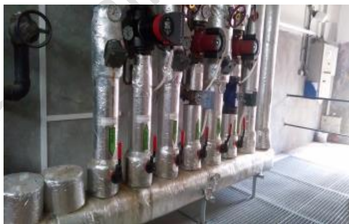
Obrázek 26 – Rozvaděč+sběrač, OPS YA
