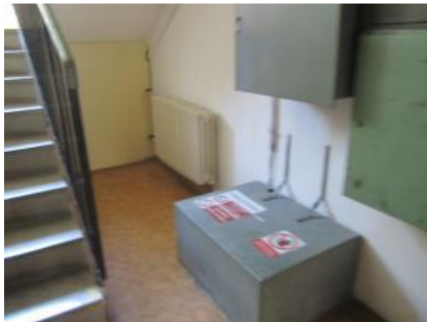
Obrázek 19 – Článkové OT, chodba vstup
