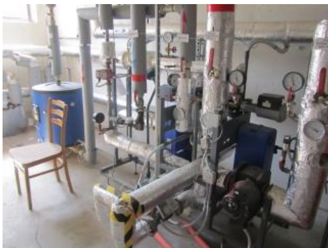
Obrázek 21 – Výměňíková stanice OPS YC
