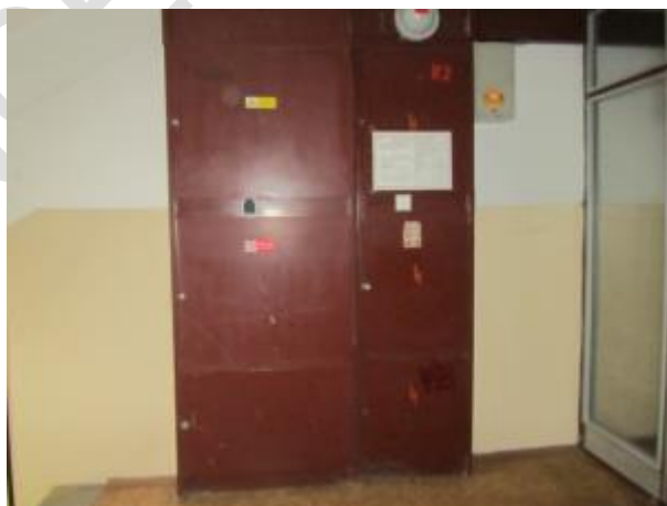
Obrázek 29 – Rozvodná a pojistná skříň v patře objektu
