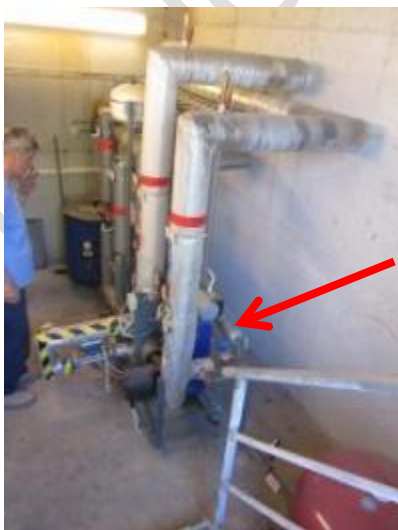
Obrázek 23 – Výměňková stanice OPS YD
