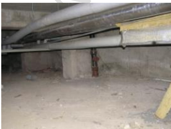
Obrázek 20 – Rozvody horkovodu pod objektem, v technickém kolektoru
