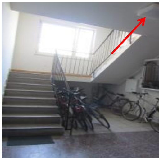
Obrázek 25 – Žárovkové svítidlo, schodiště
