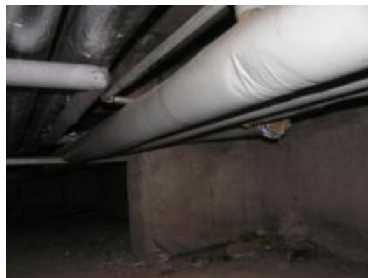
Obrázek 21 – Rozvody horkovodu pod objektem, v technickém kolektoru
