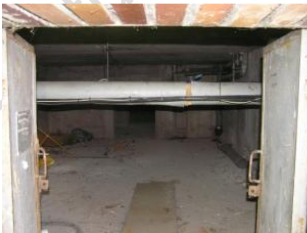
Obrázek 19 – Rozvody horkovodu pod objektem, v technickém kolektoru
