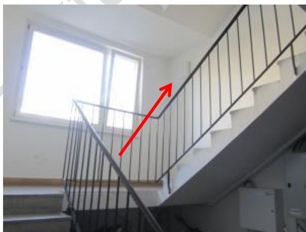
Obrázek 26 – Žárovkové svítidlo, schodiště
