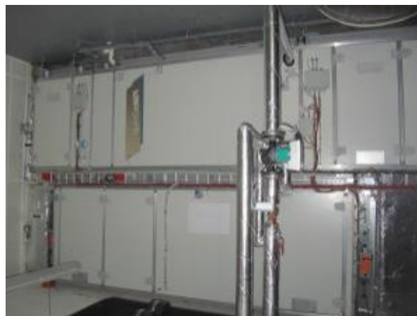
Obrázek 46 – Jednotka VZT č. 230104.10/ 0001
