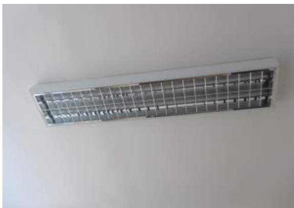
Obrázek 54 – Klasická zářivková trubicová svítidla 2x 36W, chodby objektu Q2
