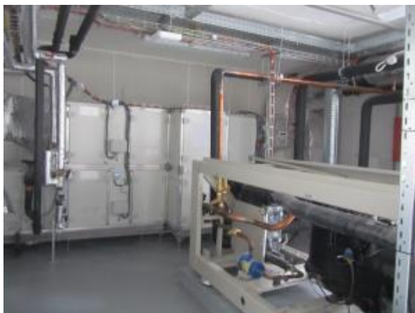
Obrázek 45 – Jednotka VZT č. 230104.40/ 0004
