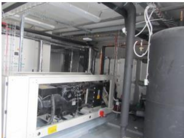
Obrázek 47 – Strojovna chlazení, objekt Q2
