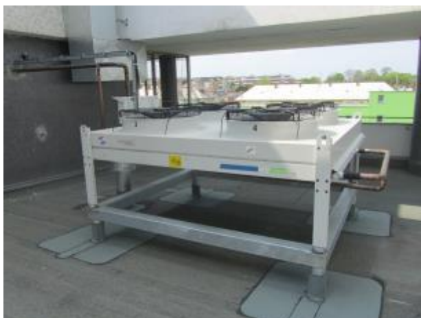
Obrázek 51 – Oddělená kondenzátor DAIKIN C-253-010-00-REV-C, střecha objektu Q2
