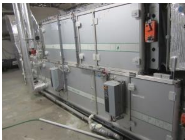
Obrázek 44 – Jednotka VZT č. 4
