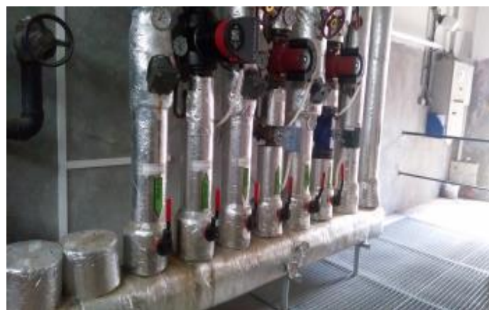
Obrázek 26 – Rozvaděč+sběrač, OPS YA
