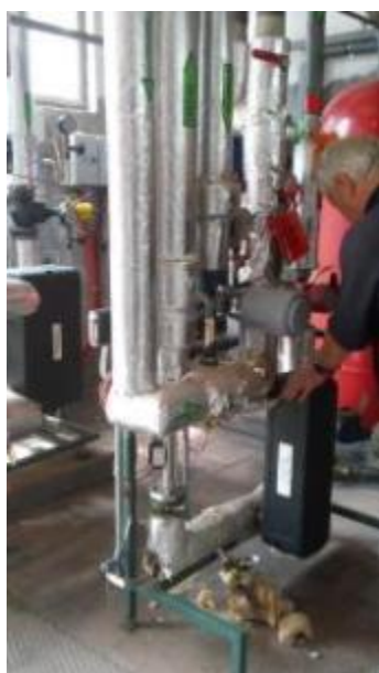
Obrázek 34–Výměňková stanice OPS YA
