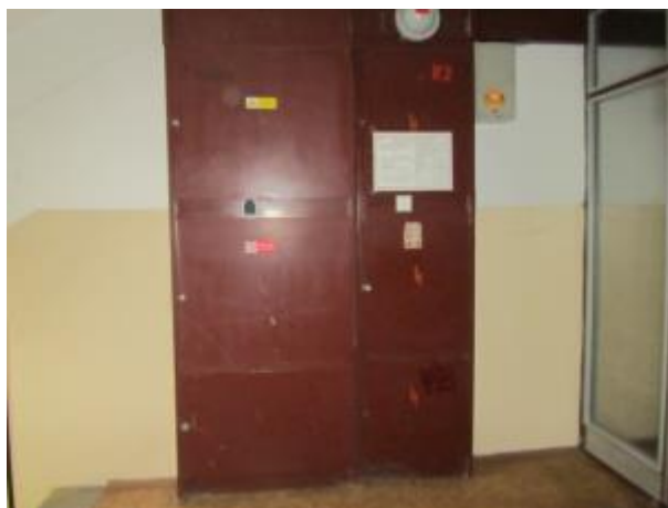
Obrázek 29 – Rozvodná a pojistná skříň v patře objektu
