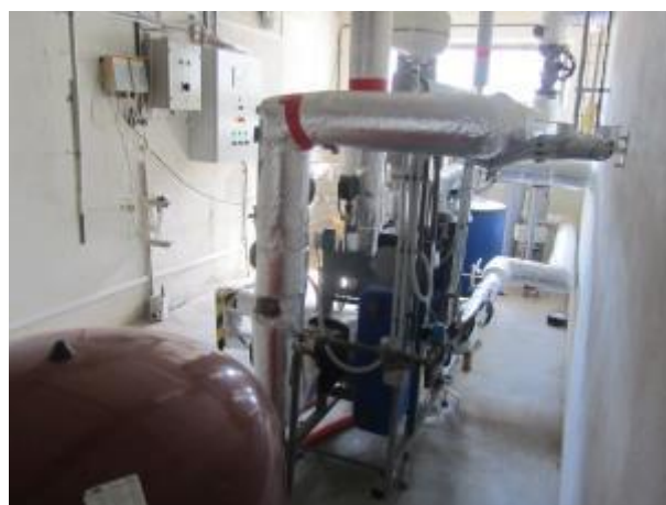
Obrázek 16–Předávací stanice OPS YC
