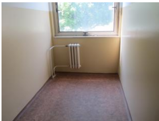
Obrázek 20 – Chodba k bytům, vytápěno
