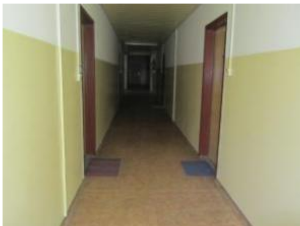
Obrázek 12 – Chodba k bytům, vytápěno
