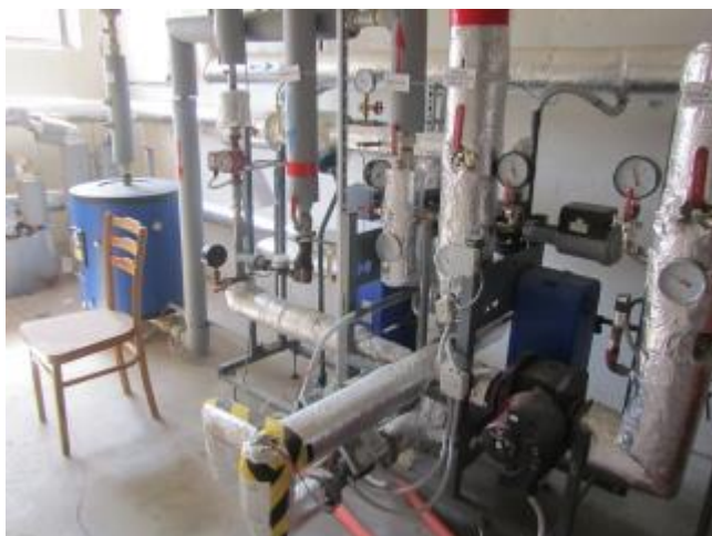
Obrázek 21 – Výměňiková stanice OPS YC
