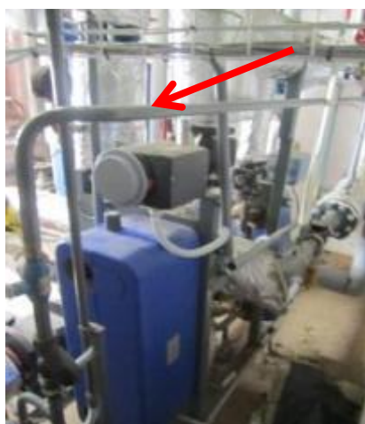
Obrázek 22–Výměňková stanice OPS YD
