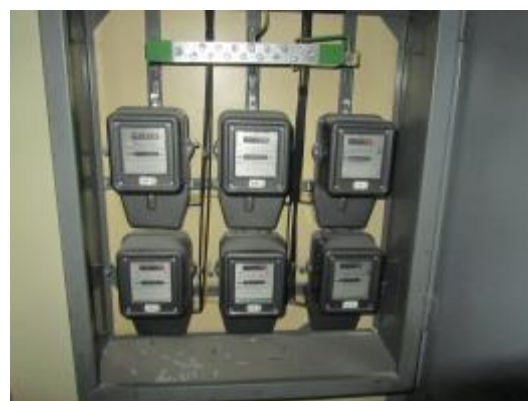
Obrázek 33 – Podružná měřidla pro bytové jednotky na patře objektu, elektromechanický jednofázový elektroměr EJ914K
