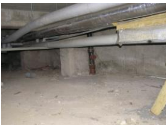
Obrázek 20 – Rozvody horkovodu pod objektem, v technickém kolektoru
