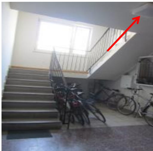
Obrázek 25 – Žárovkové svítidlo, schodiště
