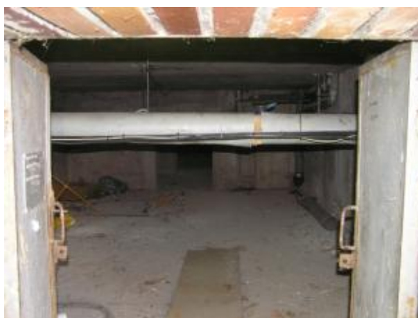
Obrázek 19 – Rozvody horkovodu pod objektem, v technickém kolektoru
