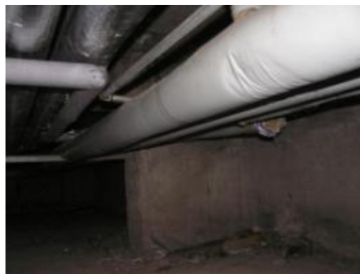
Obrázek 21 – Rozvody horkovodu pod objektem, v technickém kolektoru
