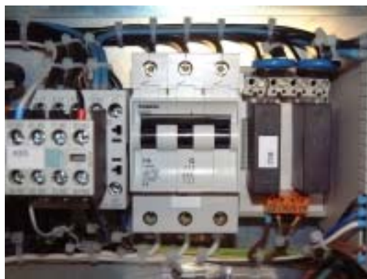
Podružný jistič – izolační transformátor se 3 fázemi C16A
